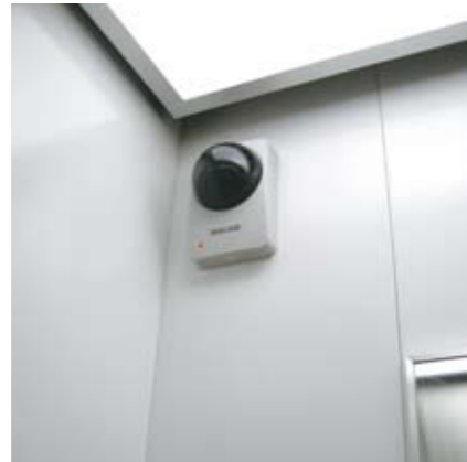
■エレベーター内に設置した監視カメラ。
